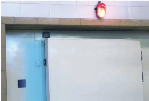
▲ Gestión energética de cámaras frigoríficas.
